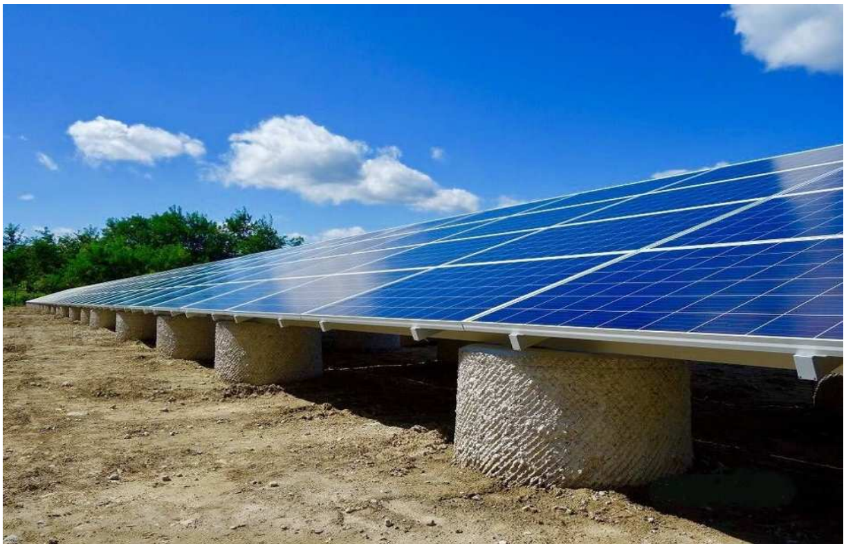
使用例：太陽光パネル基礎コンクリート
